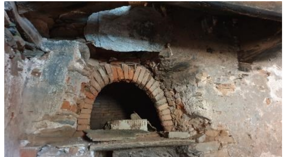
le refouloir de fumée
