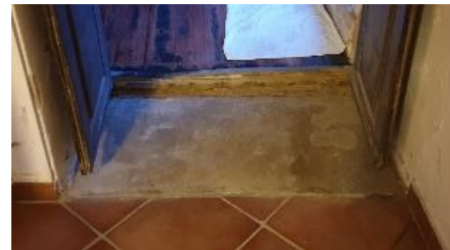
vers la pièce SE SO cette marche a été comblée par la dalle construite en 2004 en remplacement du plancher écroulé
