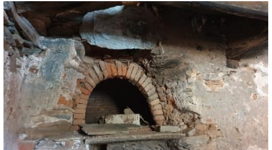
le refouloir de fumée
