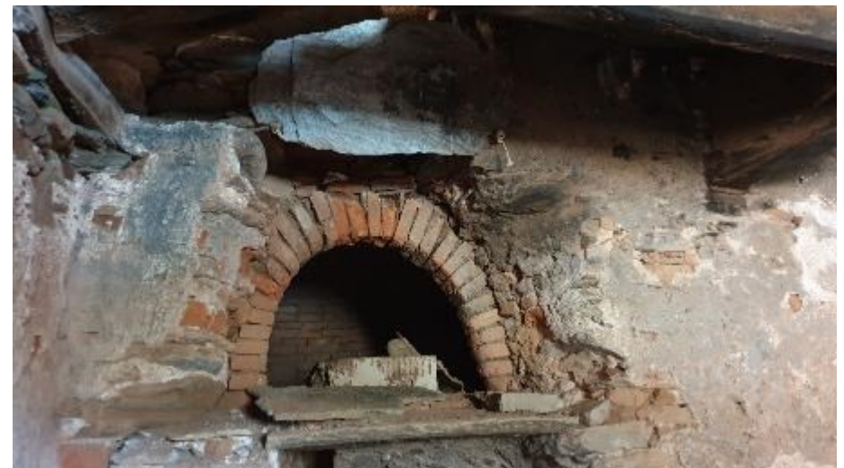
le refouloir de fumée
