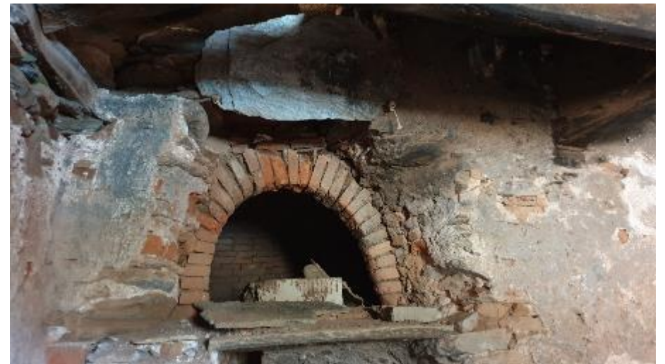
le refouloir de fumée
