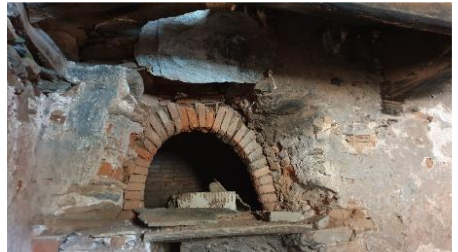
le refouloir de fumée
