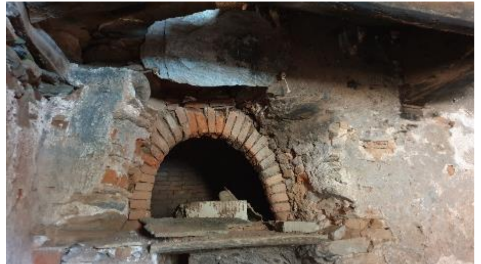
le refouloir de fumée
